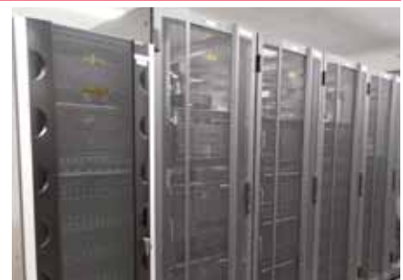
システムサーバー群
